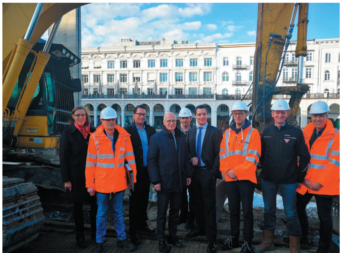
Besuch auf der Baustelle: Bürgermeister Peter Tschentscher (Vierter von links) machte sich ein Bild von den Arbeiten in der Rathauspassage.
